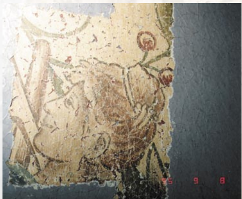
In der Schwedter Straße 267 in Berlin Mitte wurden alte Wandmalereien freigelegt. Diese sind denkmalgeschützt und in der Denkmalliste Berlin aufgelistet.
